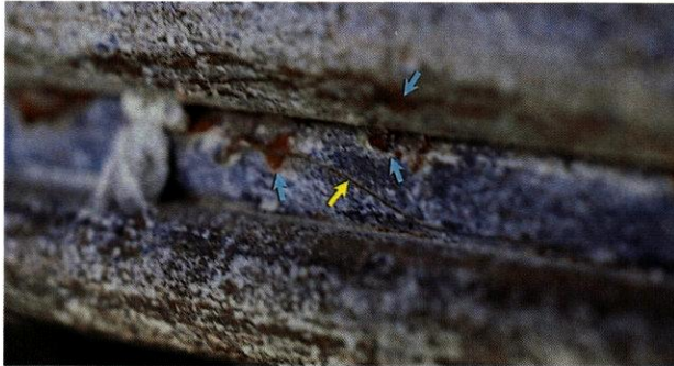
Figura 118. Imagen de un alambre de postensado de una abertura de inspección cerca del punto medio de la Viga Norte en el Sitio B, con corrosión por picaduras (flechas azul) y señales de agrietamiento (flecha amarilla).
