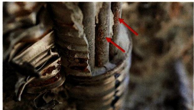
Figura 96. Áreas con manchas de corrosión entre los alambres, vista desde abajo del ducto expuesto (flechas rojas) en la abertura cerca del punto un cuarto de la Viga Norte.
