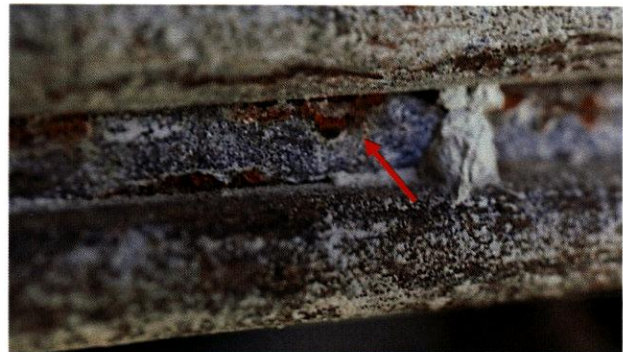
Figura 94. Ejemplo de una característica similar a una grieta en los alambres de postensado (flecha roja) en la abertura cerca del punto medio de la Viga Norte.
