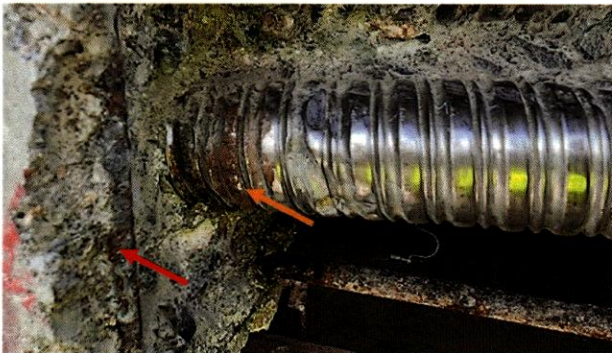
Figura 90. Ducto metálico brillante con solo manchas de corrosión menores (flecha naranja) cerca de la ubicación del estribo (flecha roja) en la abertura cerca del punto de un cuarto de la Viga Norte.
