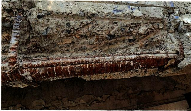
Figura 88. Manchas típicas de corrosión en el acero de refuerzo y el exterior del ducto, en la abertura situada cerca del punto medio de la Viga Norte.
