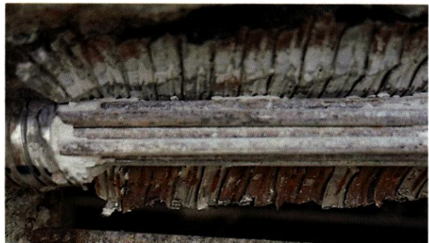
Figura 91. Corrosión en la superficie interior del ducto corrugado en la abertura cerca del punto de un cuarto de la Viga Norte.
