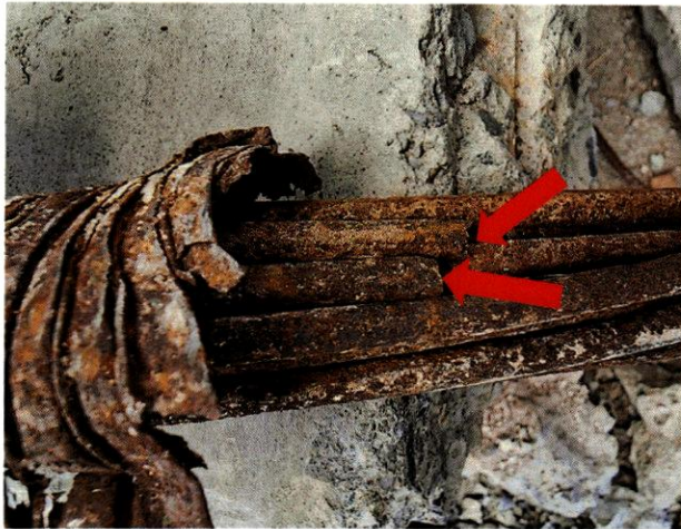
Figura 86. Se observaron dos alambres fracturados dentro del ducto del tendón postensado del espécimen de viga F-A-BM-12 (flechas rojas).
