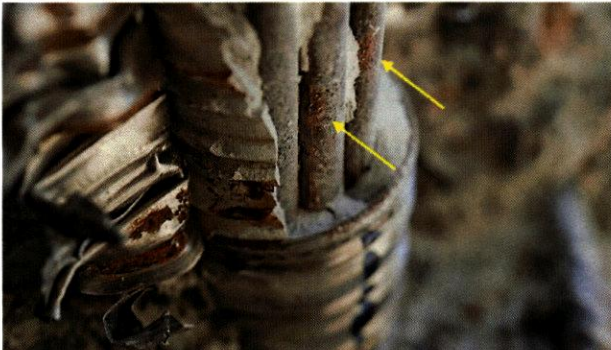
Figura 109. Vista inferior del ducto expuesto con la lechada y los alambres de postensado a la vista. Obsérvense las zonas con manchas de corrosión en los alambres (flechas amarillas)
