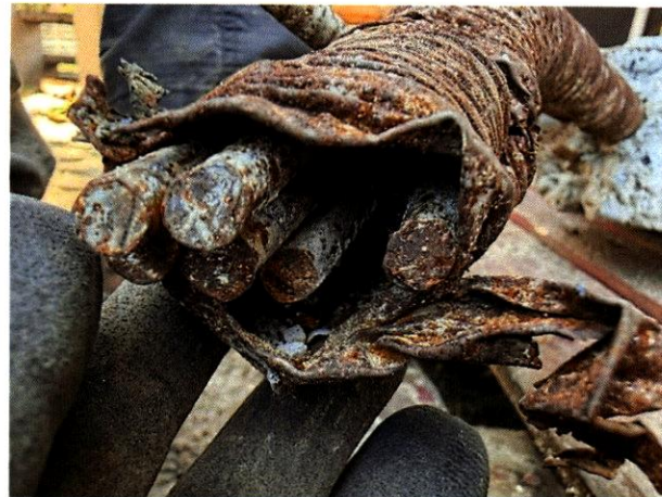
Figura 87. Ocho alambres visibles dentro del ducto del tendón de postensado del espécimen de viga F-C-BM-10.
