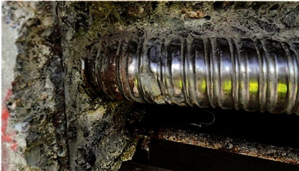
Figura 107. Vista de la superficie exterior del ducto del tendón en la abertura de inspección del cuarto de la Viga Norte en el Sitio B
