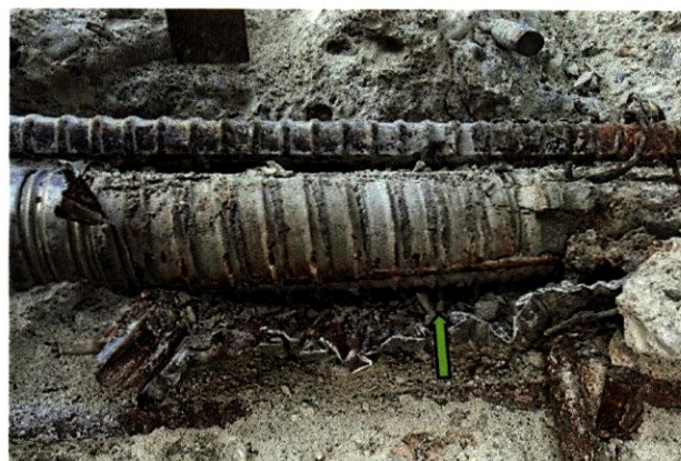
Figura 112. Acercamiento del borde inferior de la apertura de la viga, mostrando manchas de corrosión en el exterior de la lechada expuesta (flecha verde).
