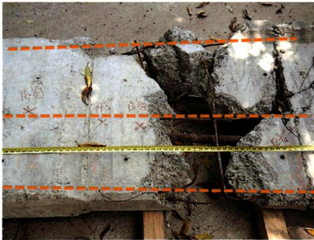
Figura 78. Tres filas de refuerzo longitudinal en el espécimen de viga F-C-BM-10. Las líneas discontinuas en color naranja ilustran el refuerzo.
