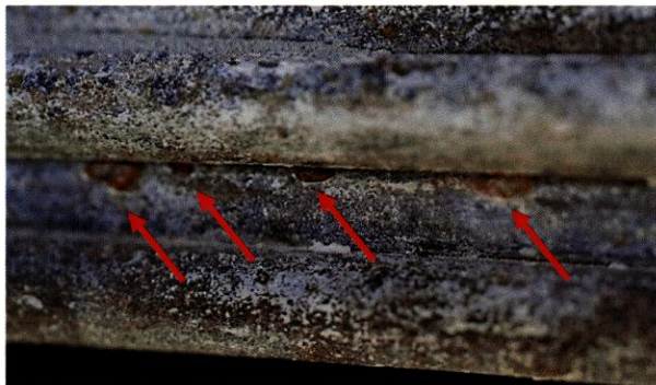
Figura 95. Ejemplos de áreas de corrosión dentro de los alambres de postensado (flechas rojas) en la abertura cerca del punto medio de la Viga Norte.
