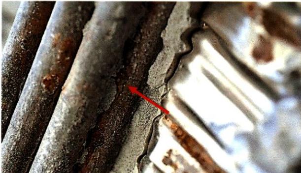
Figura 93. Característica similar a una grieta en el cable expuesto en la vista inferior con manchas de corrosión en la abertura cerca del punto un cuarto de la Viga Norte (flecha roja).
