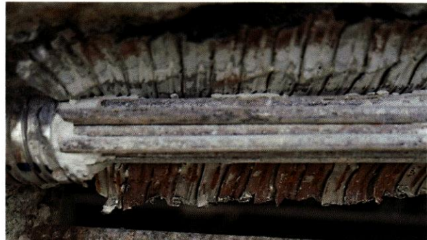
Figura 108. Vista de la superficie interior del ducto del tendón en la abertura de inspección del cuarto de la Viga Norte en el Sitio B.
