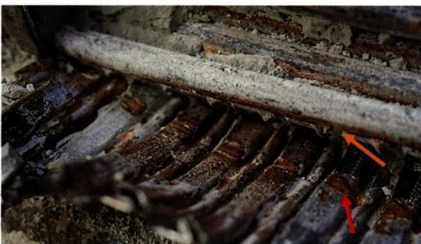
Figura 92. Alambre de postensado corroído (flecha naranja) adyacente a la mancha en el interior del ducto corrugado (flecha roja) en F-A-BM-9.
