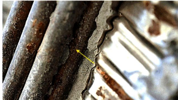
Figura 110. Vista inferior adicional del cable expuesto con manchas de corrosión. Obsérvense las características similares a grietas en el alambre expuesto (flecha amarilla)
