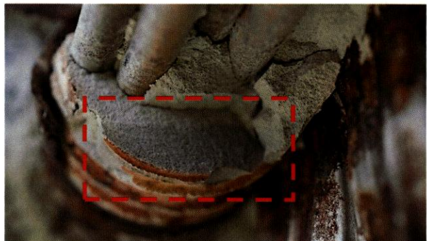
Figura 100. Lechada más oscura en la parte inferior del tendón, en la abertura cerca del centro de la Viga Norte (recuadro rojo).
