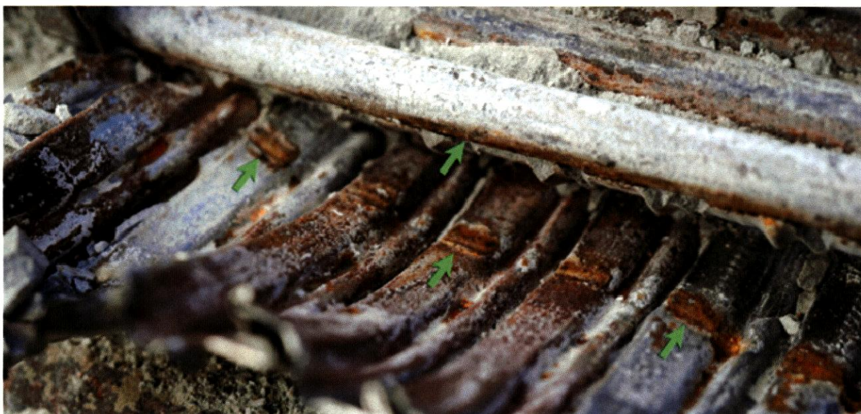
Figura 113. Evidencia de contacto directo entre el alambre y el ducto en la misma ubicación que se muestra en la Figura 111.
