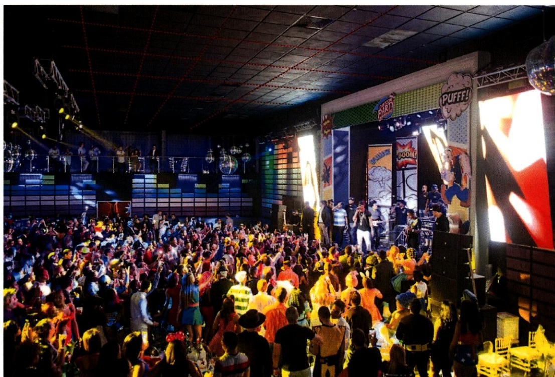
Figura 68. Imagen de la discoteca Jet Set inmediatamente después de su reapertura en 2015. Se añadieron líneas rojas anotadas a lo largo de determinadas líneas de la retícula de plafones para proporcionar una indicación de la rectitud y nivelación del techo suspendido.
