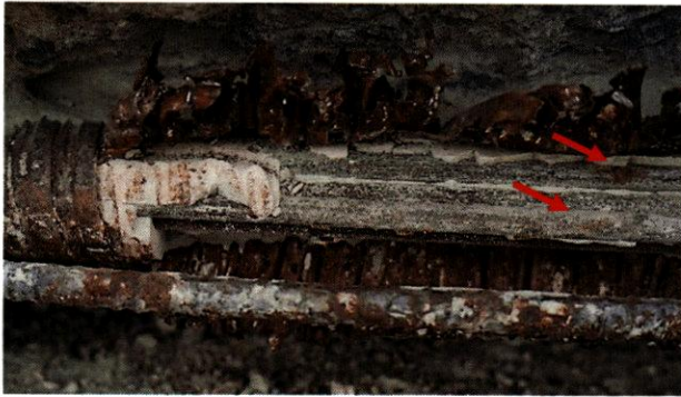
Figura 97. Manchas de corrosión en los alambres en la abertura cerca del punto medio de la Viga Sur (flechas rojas)
